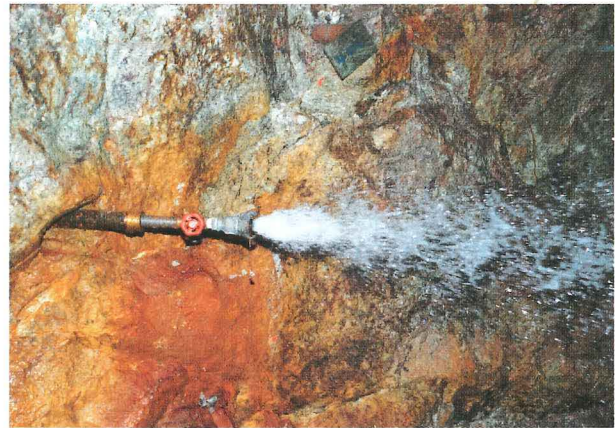
Unter hohem Druck stehender Spaltenwasseraustritt aus einer Sondierungsbohrung im Bärhaldegranit der Grube Krunkelbach, Menzenschwand, Südschwarzwald
