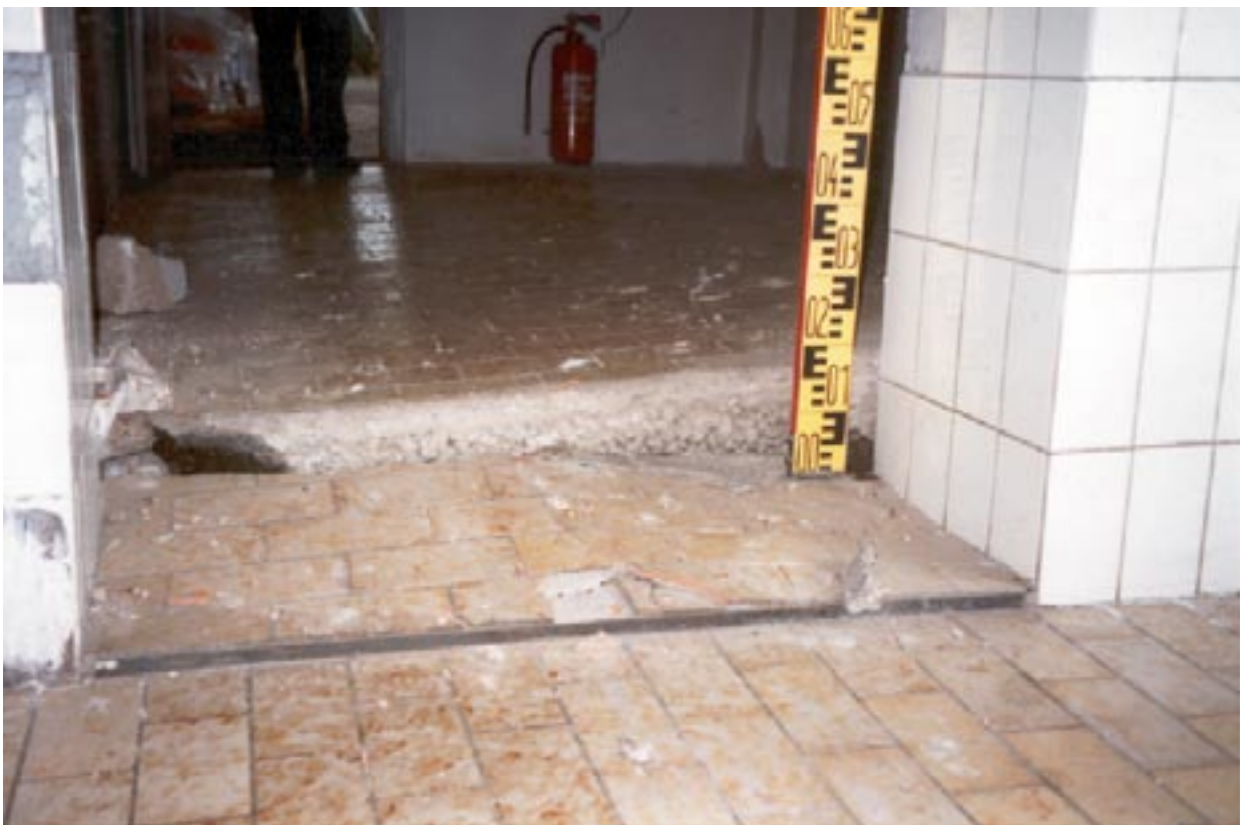
Abb. 44: Deformation des Fußbodens einer Halle im Zollernalbkreis durch Hebung im Posidonienschiefer (Foto RUCH)
