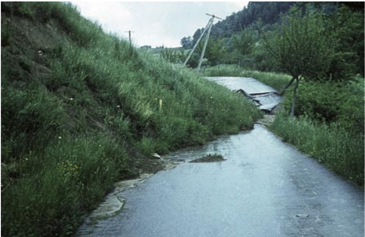
Abb. 18: Rutschung im Opalinuston an der Straße Achdorf – Eschach (Wutachgebiet)
