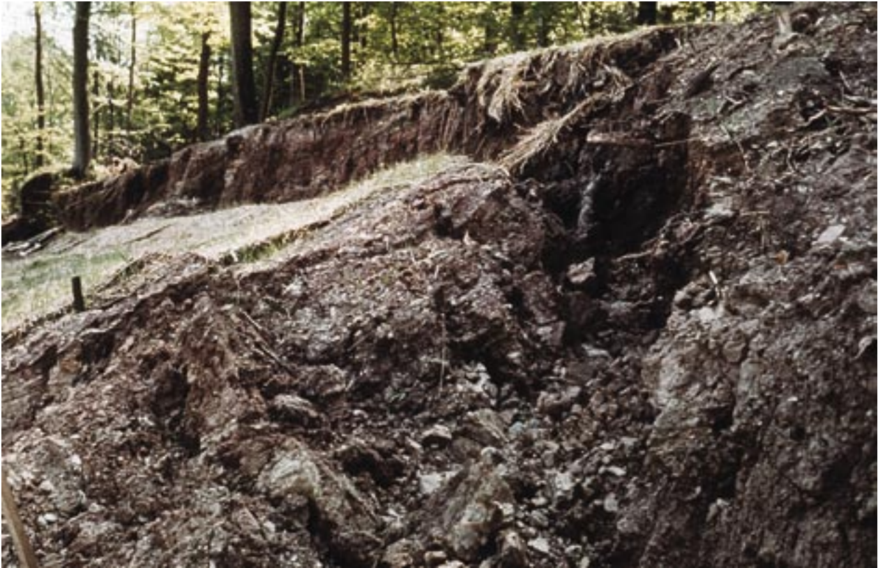
Abb. 29: Bergseitiger Abriss einer Großschollenrutschung im Gipskeuper des Wildenbergs (Foto BRUDER)
