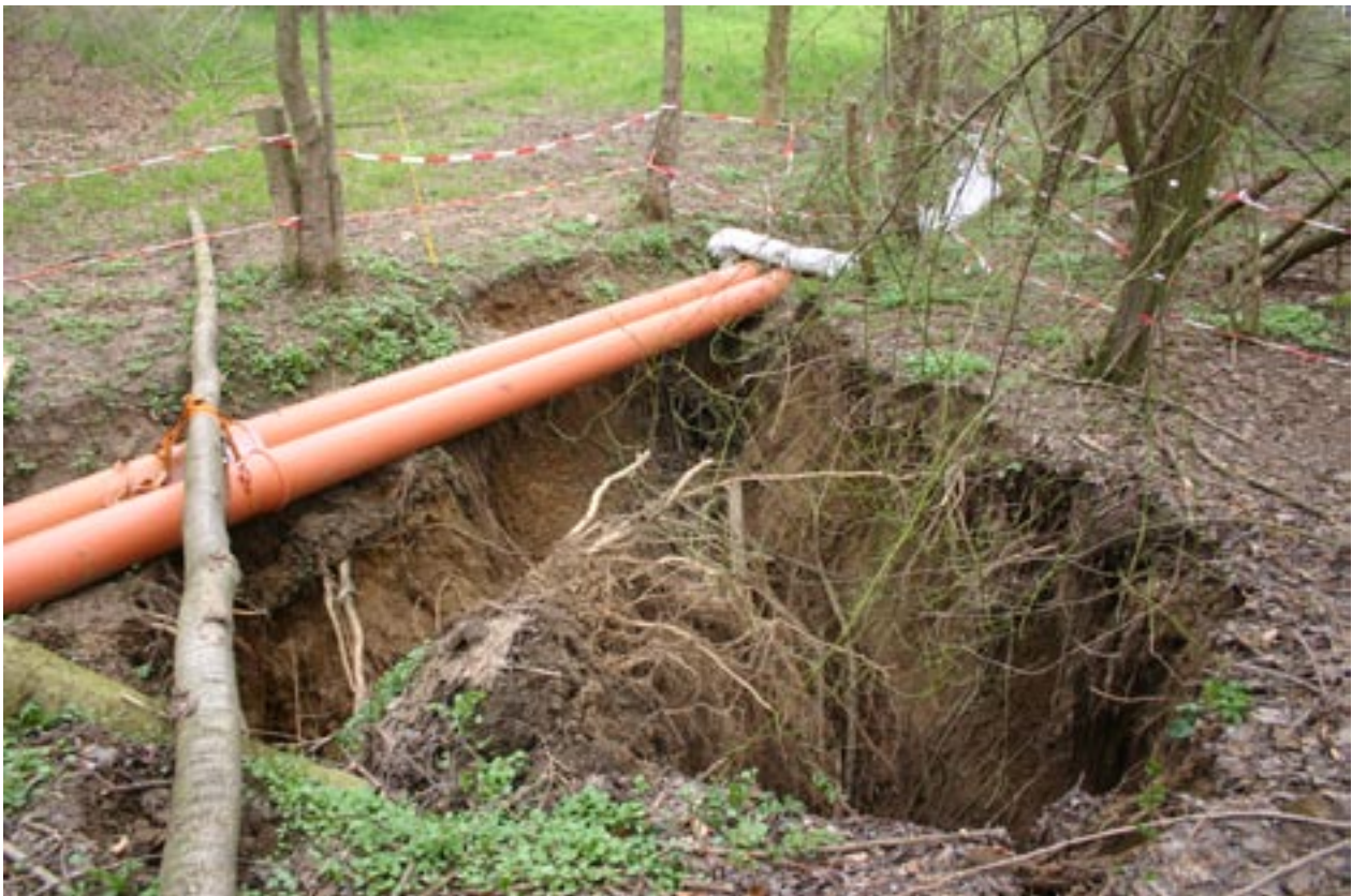
Abb. 39: Erdfall im Oberen Muschelkalk mit Nachbruch im Auenlehm des Maubachs, südlich Backnang. Der Bach versickerte vollständig im Oberen Muschelkalk und wurde deshalb in provisorischen Rohrleitungen über die Versickerungsstelle geführt
