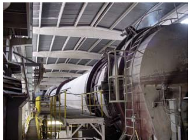
Abb. 134 Drehofen zur Erzeugung von Portlandzementklinker im Zementwerk Schelklingen der HeidelbergCement.
