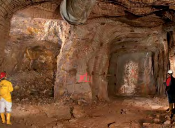
Abb. 133: Streckenvortrieb auf zwei parallelen Gangstrukturen in der Grube Clara, Diagonaltrum auf der Sohle 8.3.
