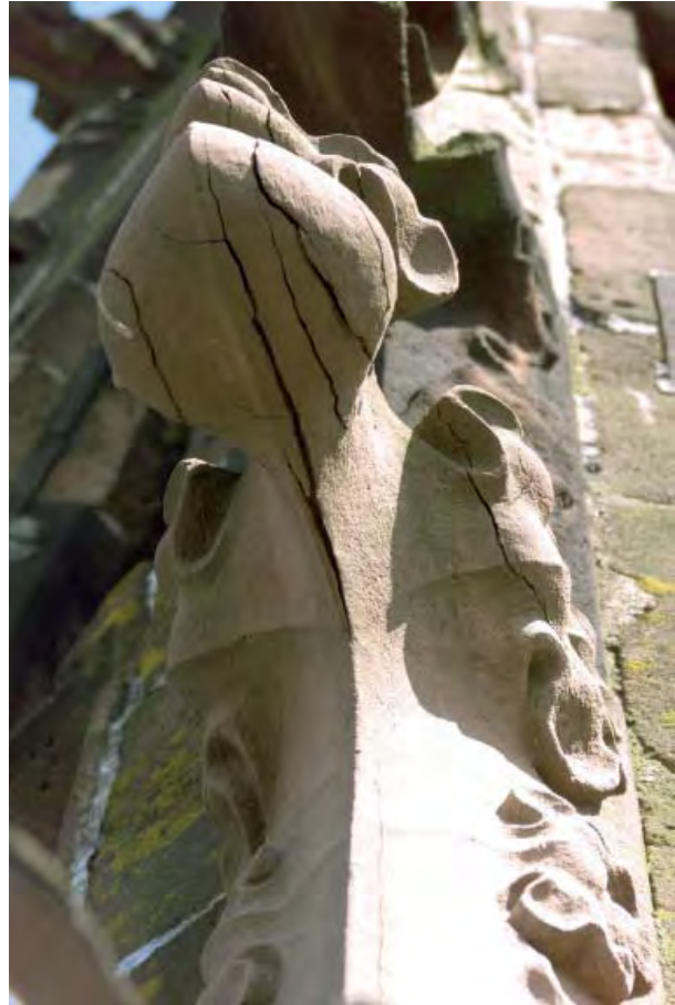
Abb. 43: Stark geschädigte Krabbe am Turmhelm des Freiburger Münsters; dieser unter den herrschenden Witterungsbedingungen nicht geeignete Feinsandstein aus Steinbrüchen bei Freudstadt war erst in der Mitte des 20. Jh. eingebaut worden; der umgebende Sandstein aus den Steinbrüchen bei Tennenbach zeigt sich hingegen seit über 700 Jahren stabil gegen Witterung und statische Beanspruchung.
