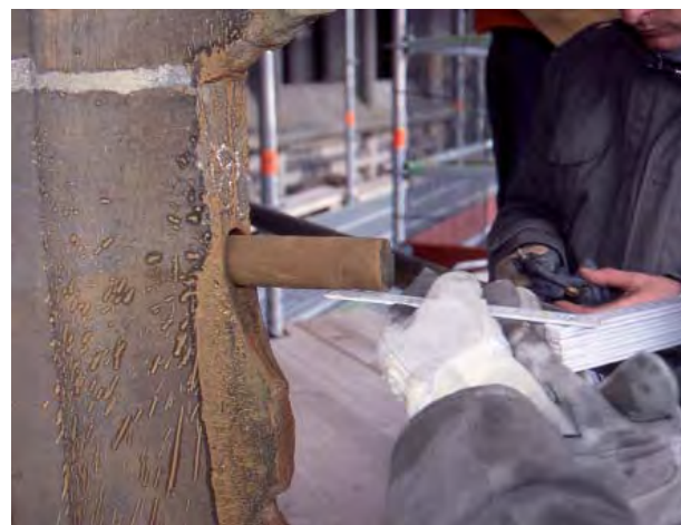
Abb. 36: Probeentnahme am Ulmer Münster zum petrographischen und geochemischen Vergleich geschädigter und intakter Eisensandsteine aus der mittelalterlichen Bauphase.
